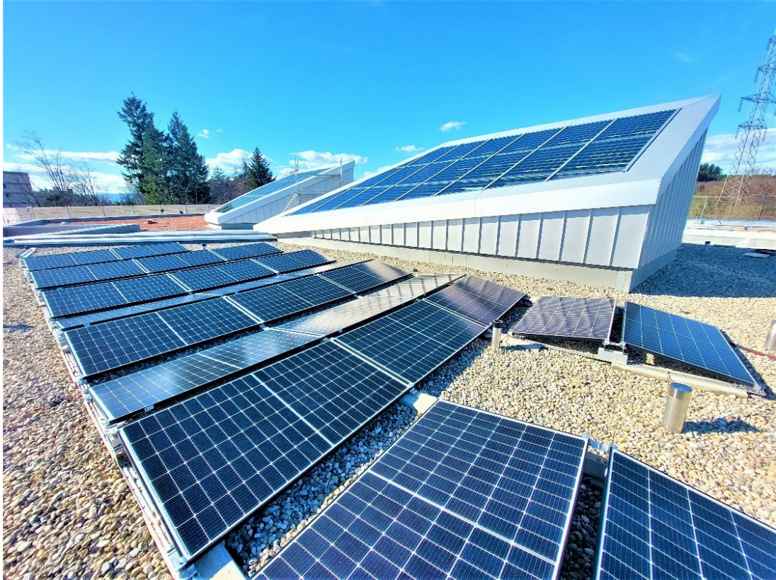
L'installation photovoltaïque de l'école de Bois-Murat a été financée de manière participative. Elle est construite en trois étapes sur trois toits. Image : Epalinges
